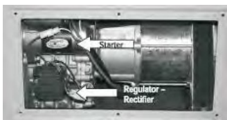
Figura C - Posizione del pannello di accesso posteriore (rimosso).   possibile vedere la posizione del motorino di avviamento e del raddrizzatore/ponte raddrizzatore per la batteria di avviamento a 12 V. Il motorino di avviamento si trova sopra il ponte raddrizzatore/raddrizzatore.
